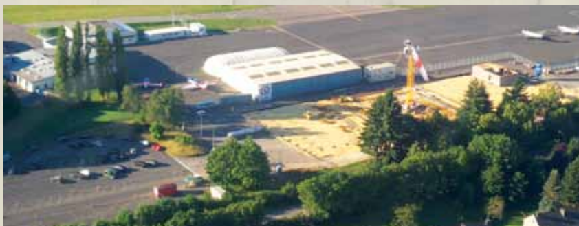
Die Arbeiten für das neue LAR Gebäude am Findel haben bereits begonnen.
